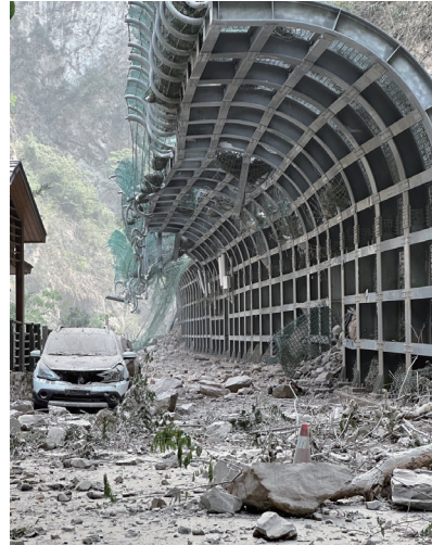
照片3 0403地震燕子口步道落石造成嚴重毀損（花蓮縣消防局攝）
