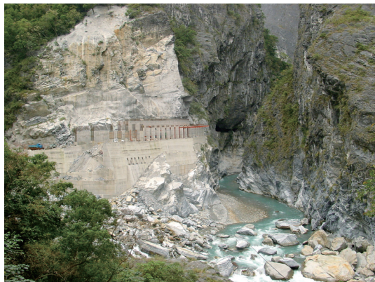
照片2 燕子口與斬珩橋附近因地質破碎、地形陡峭、地震與豪雨造成大面積的崩塌
