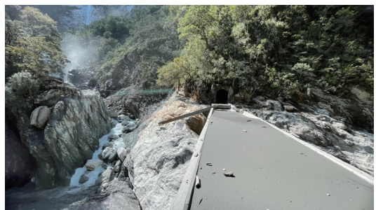
照片5 康芮颱風對白楊步道塔次基里溪版橋、吊橋與觀景平台造成二次災害（何文晟攝）
